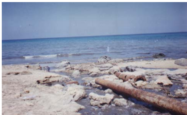
Figure 4 : Emissaire d'eaux usées dans la station « St 5 »
